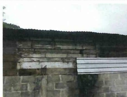
Foto 2: Paredes en mal estado, se hará un mejoramiento para trasladar alumnos que se encuentran en zona de riesgo.
