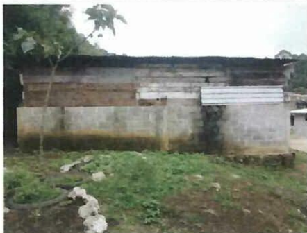
Foto 1: Se necesita realizar un mejoramiento de las paredes del módulo de aulas, debido a que se encuentran en mal estado.
